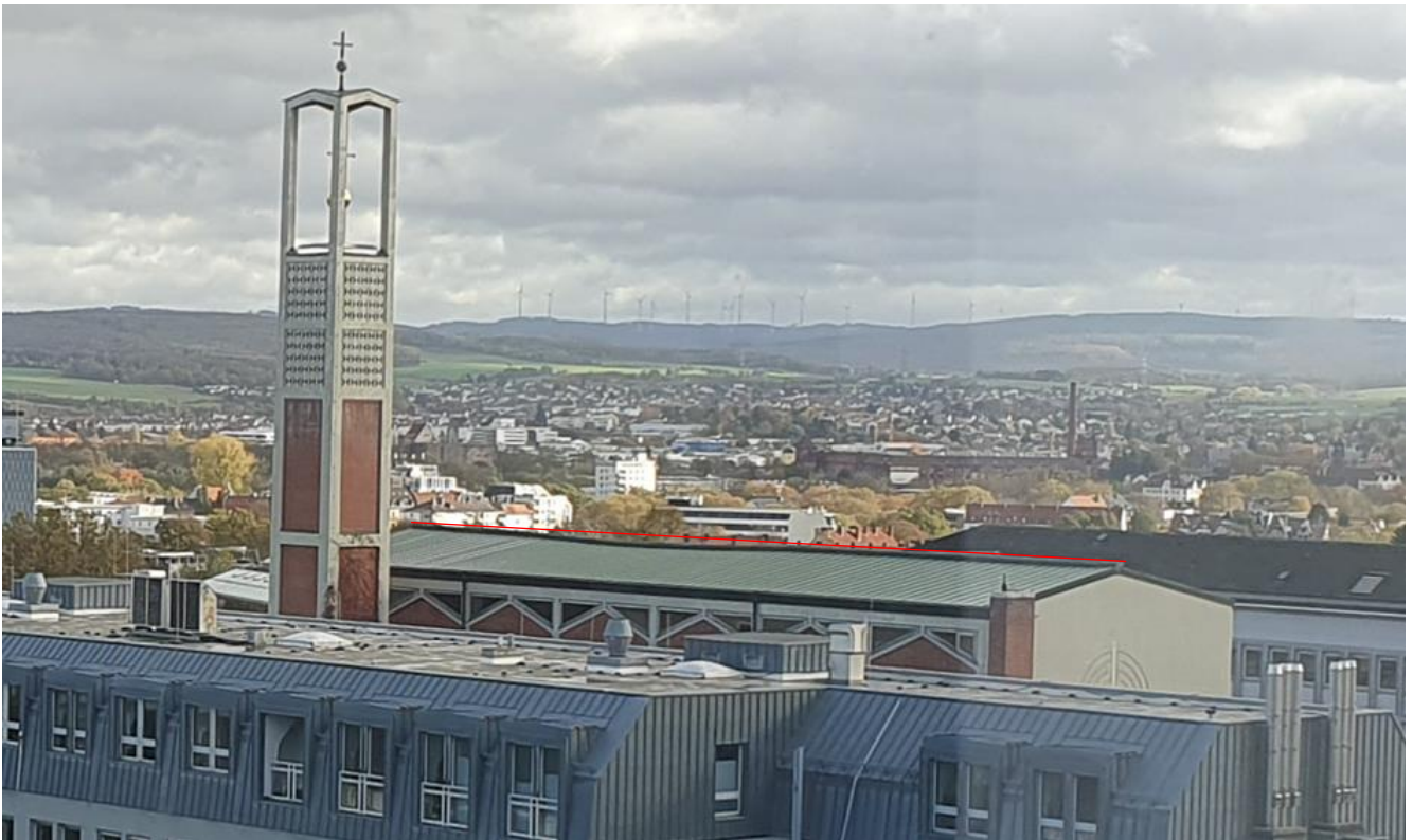
Abb. 6 Bildausschnitt Dachfirst mit Durchbiegung
