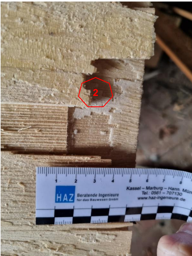
Abb. 24 Detail gebrochene Keilzinkenverbindung mit Größenvergleich
