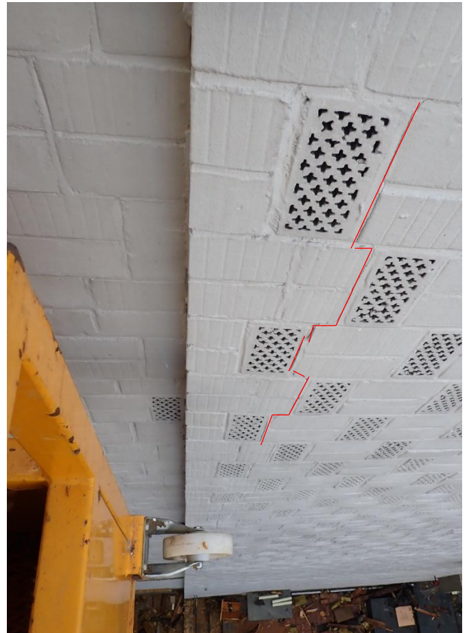
Abb. 17 Innere Vormauerschale mit Absturzschäden in Eckbereichen sowie Rissen
