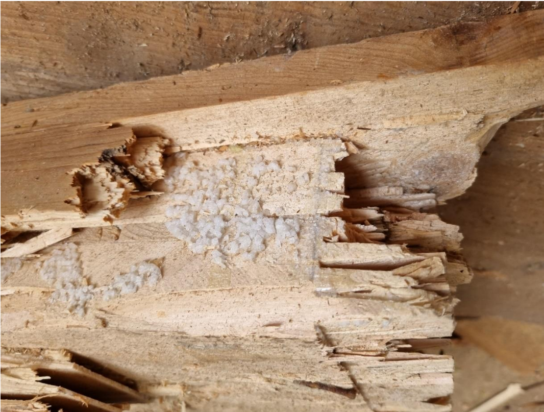
Abb. 20 Leimfuge zwischen Unterseite Stegplatte und Blendbrett mit zu dicker, versprödeter Leimfuge
