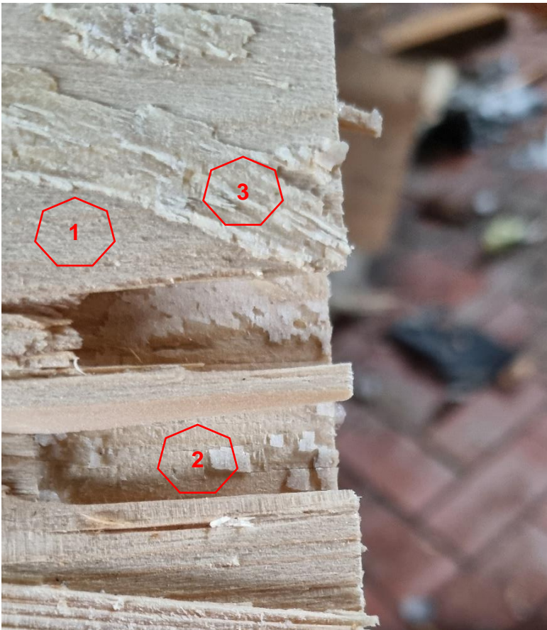
Abb. 23 Detail gebrochene Keilzinkenverbindung (1) kein Leim vorhanden; (2) Leim versprödet und würfelartig gebrochen; (3) Bruch in den Holzfasern
