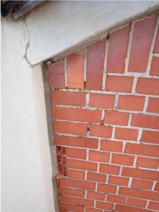
Abb. 16 Schäden am Ziegelmauerwerk der Ausfachungen
