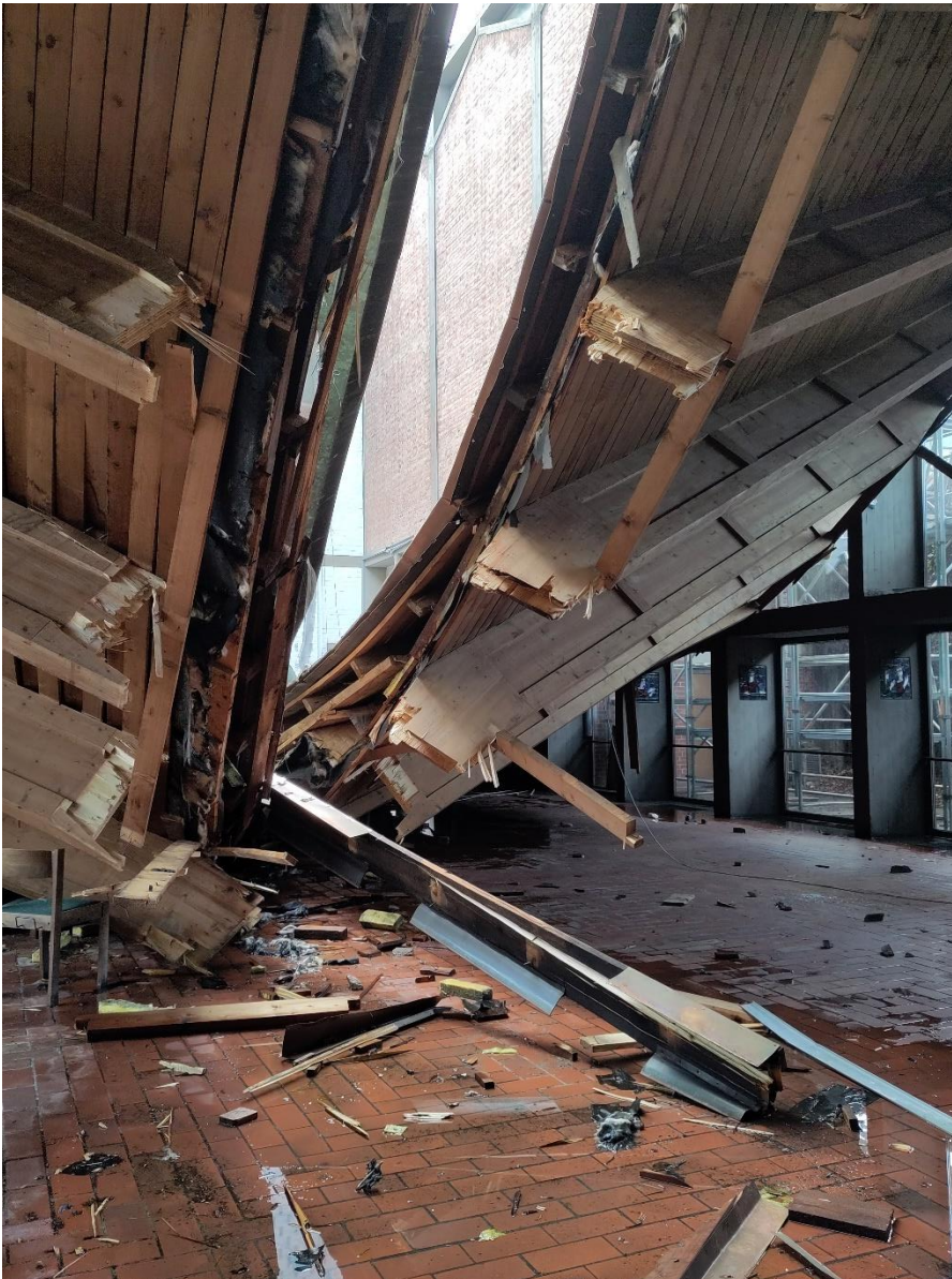
Abb. 14 Blick in den Bruchstellen der Dachbinder
